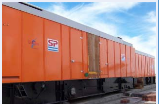
Termoeléctrica Río Gallegos
