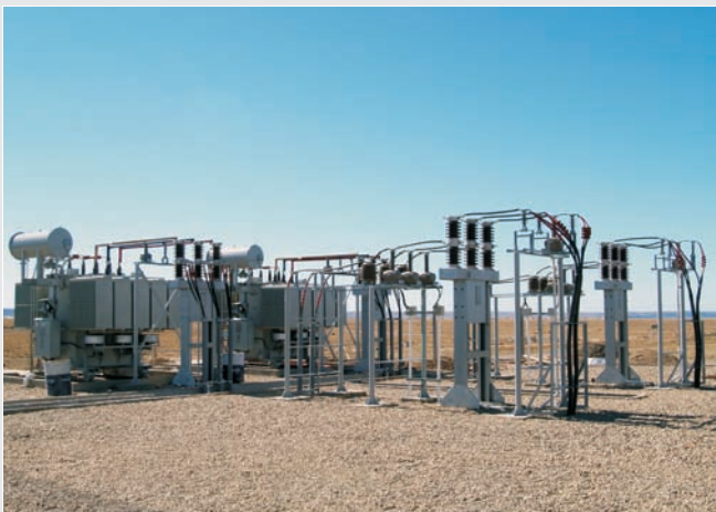
Estación transformadora 10,4/33kV - 50 MVA Santa Cruz, Río Chico
