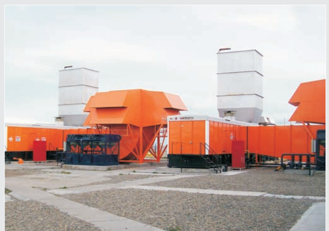
Planta de generación de energía eléctrica 35.000 kW Santa Cruz, Río Chico
