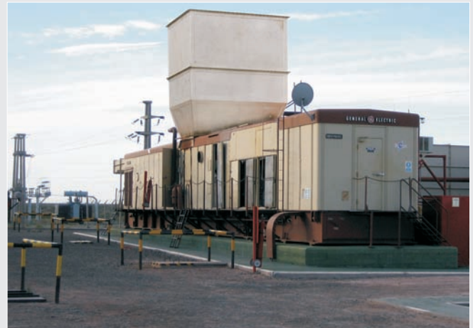
Planta de generación de energía eléctrica 1 x 18.500 kW Yacimiento Entre Lomas
